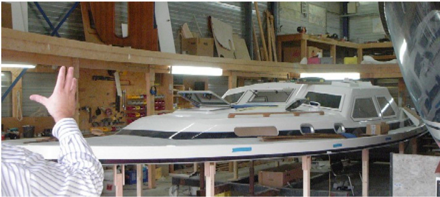
oben: Fast fertiges Deck in der Montage. Deck und Rumpf werden so weit wie's geht getrennt gebaut und erst ganz zum Schluss zusammen gesetzt.
